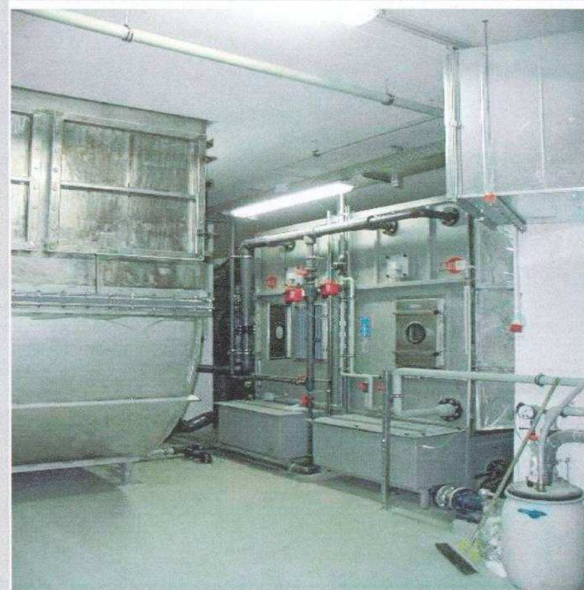
Wäscher und Rohgaseintritt in den Biotropfkörper
