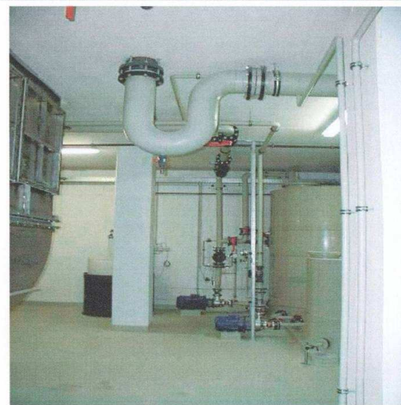
Wassertechnik mit Beregnungsvorlagen, Pumpen etc.
