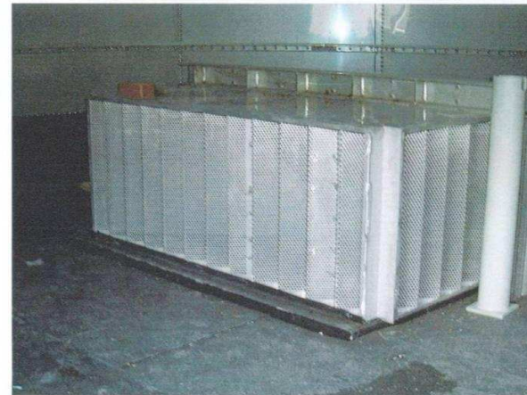
Einströmöffnungen zur optimalen Luftverteilung im Eintrittsbereich
